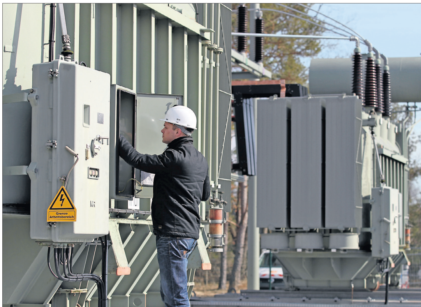
Überprüfungen an den Trafos von Umspannwerken gehören zum regelmäßigen Sicherheitscheck von Stromnetzbetreibern.
